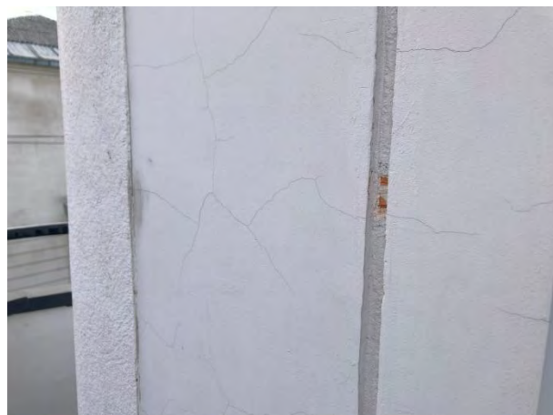
F-2. P. Višinskio g. fasadas, II a. balkono sienos dekoru elementas. Zondažas Z-2. SL-2.
